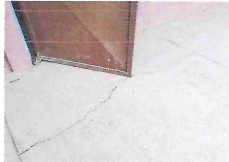
Piso en mal estado
